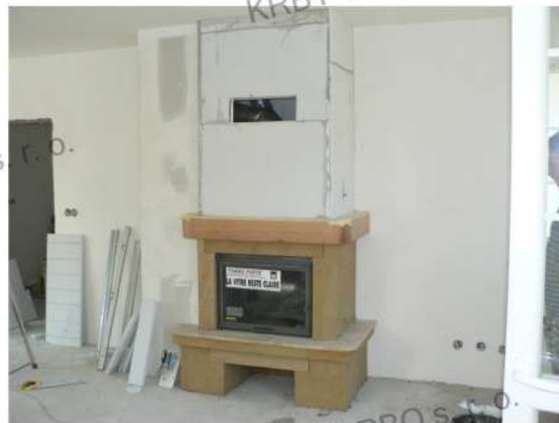
18. Po dokončení sopouchu můžete přejít na přetažení kamnářskou perlínkou Silcatex-SE. Tato perlinka má odolnost do 550°C a na rozdíl od klasické perlinky vydrží v kamnářské omítce. Běžná perlinka se v kamnářské omítce do dvou let rozpadne, což vede k porušení struktury omítky a jejímu praskání, či vypadávání.
